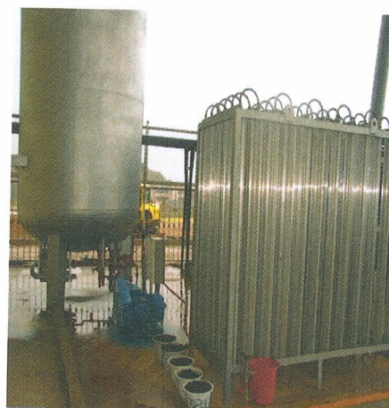
低温储槽、低温液体泵、汽化器
